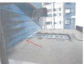
Immeuble voisin venant s'adosser sur la façade au niveau de la baie du 1er étage.
