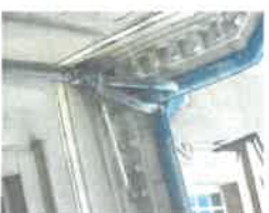
Façade Est F1 - descente EP raccordée à une descente EU à l'angle des deux pavillons sud.
