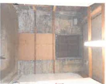
Figure 24 - Aile Nord-Ouest C - rez-de-chaussée : ancienne baie obturée suite à la construction d'un immeuble sur la parcelle voisine.
