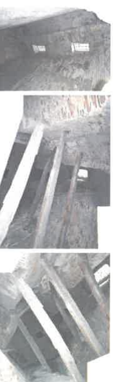
Niveaux inférieurs de la tour : maçonnerie éventrée, absence de planchers
