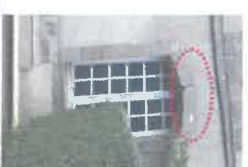
Façade Est F1 - baies F 01 et F 02 : fissure des linteaux, appuis et allège.
