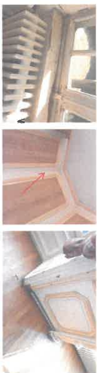
Trace d'humidité en opput de fenêtre (peinture écaillée...)
