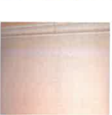
1er étage - pavillon A1 : plancher bois à sous-face enduite au plâtre avec légère fissuration
