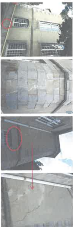
Façade Sud (F3) : traces d'humidité / ruisselement d'eau et fissures sur l'enduit de subsassement
