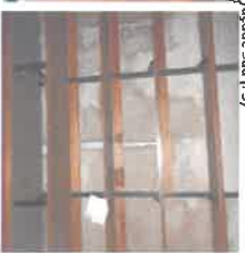
Traces d'humidité au RC du mur régnal transversal
