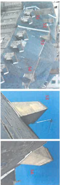
Souches de cheminée du corps de logis principal A et des pavillons A-A2
