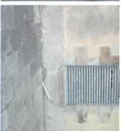
Baie obturée, écart vétuste de l'enduit du soubassement de la façade (F9)
