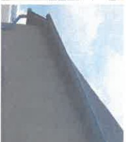
Carreaux moulurés en bois en détérioration de toit - fissures de l'enduit sur la façade Ouest (F10)
