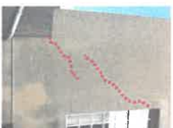
Humidité et fissuration de l'enduit et sur la façade Sud (F9)
