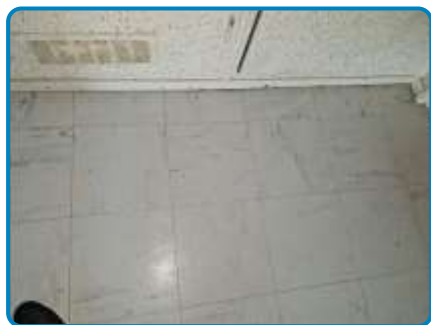
D.O. n° 1 sur Plancher Dalles de sol
