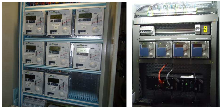
Figure 10 : Consoles de pilotage de la régulation en sous-station
