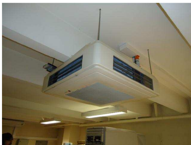
Figure 19 : Unité split-system dans le local serveur
