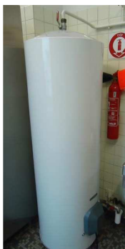
Figure 18 : Ballon ECS électrique de 300L de la crèche
