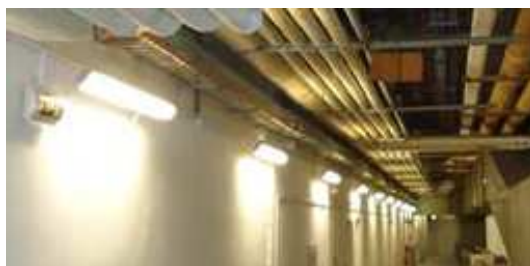
Figure 26 : Eclairage des sous-sols fréquentés
