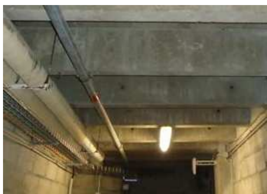
Figure 27 : Eclairage des sous-sols peu fréquentés
