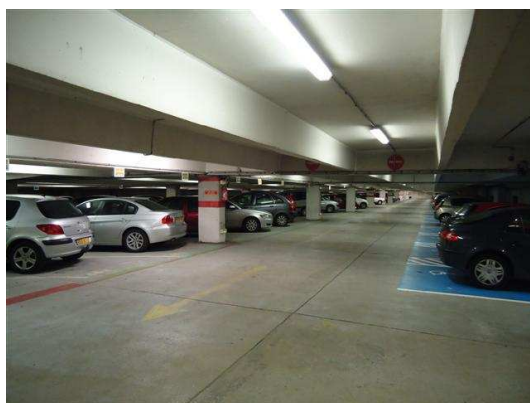
Figure 25 : Eclairage des parkings
