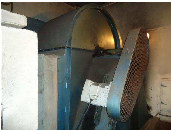
Figure 31 : Groupe de ventilation parking
