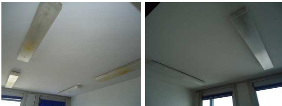
Figure 20 : Luminaires anciens - hublots réduisant le flux lumineux
