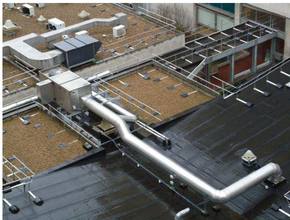
Figure 30 : Centrale de traitement d'air en terrasse
