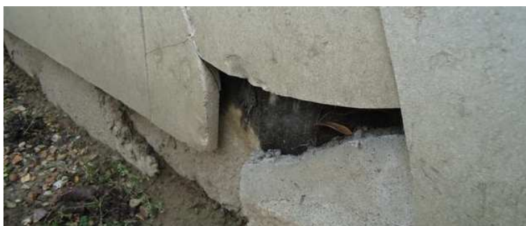
Figure 3 : Bris du parement pierre permettant une pré-analyse de la composition de paroi
