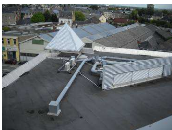
VMC bâtiment E 6000m 3 /h
