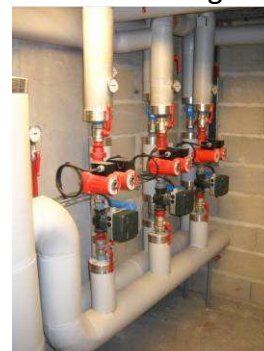
Sous-station bâtiment E
