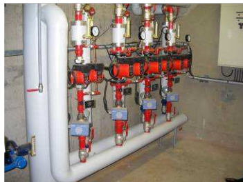
Sous-station bâtiments C-D
