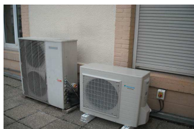
Unités extérieures DAIKIN et AIRWELL - Locaux informatiques
