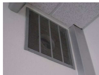
Bouche d'aspiration de la salle de réunion
