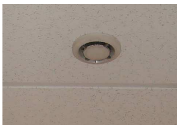
Bouche d'aspiration dans les sanitaires
