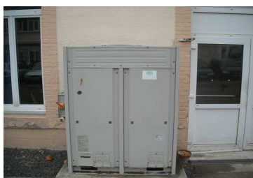
Unité extérieure DAIKIN RXY Q14 (climatisation des combles)
