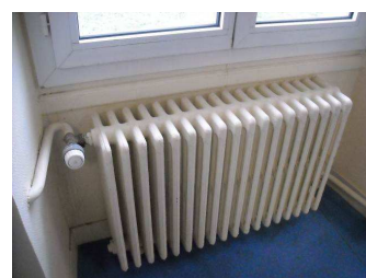
Radiateur en fonte équipé d'une vanne thermostatique
