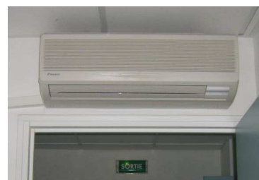
Unité intérieure au niveau des combles
