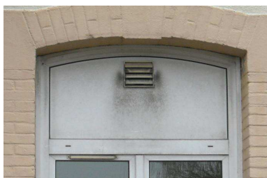
Sortie en façade de la VMC du local courrier
