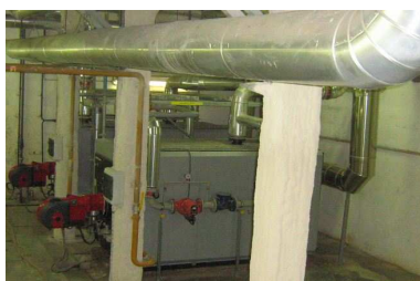
Chaufferie gaz avec réseaux calorifugés
