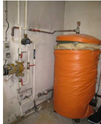
Ballon d'ECS électrique mal isolé
