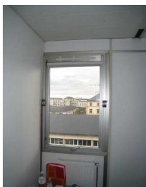
Entrée d'air bouchée
