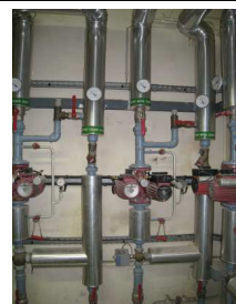
Départs calorifugés pour le bâtiment
