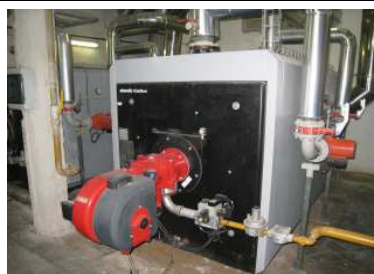
Chaudière gaz GUILLOT
