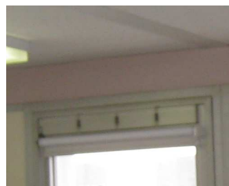
Entrée d'air sur fenêtre
