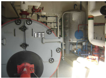
Chaufferie de la cité administrative
