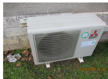
Climatiseur du local technique
