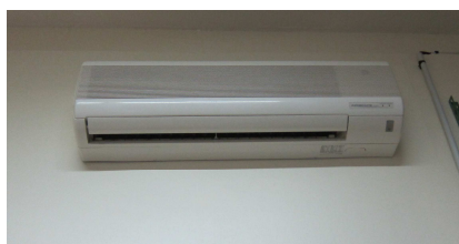
Climatiseur dulocal technique du rez de chaussée
