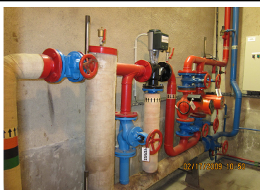
Réseau de sous chaleur
