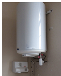
ballon d'ECS du rez de chaussée
