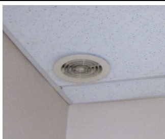
Bouches d'extraction dans un sanitaire
