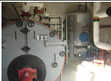
Chaufferie de la cité administrative
