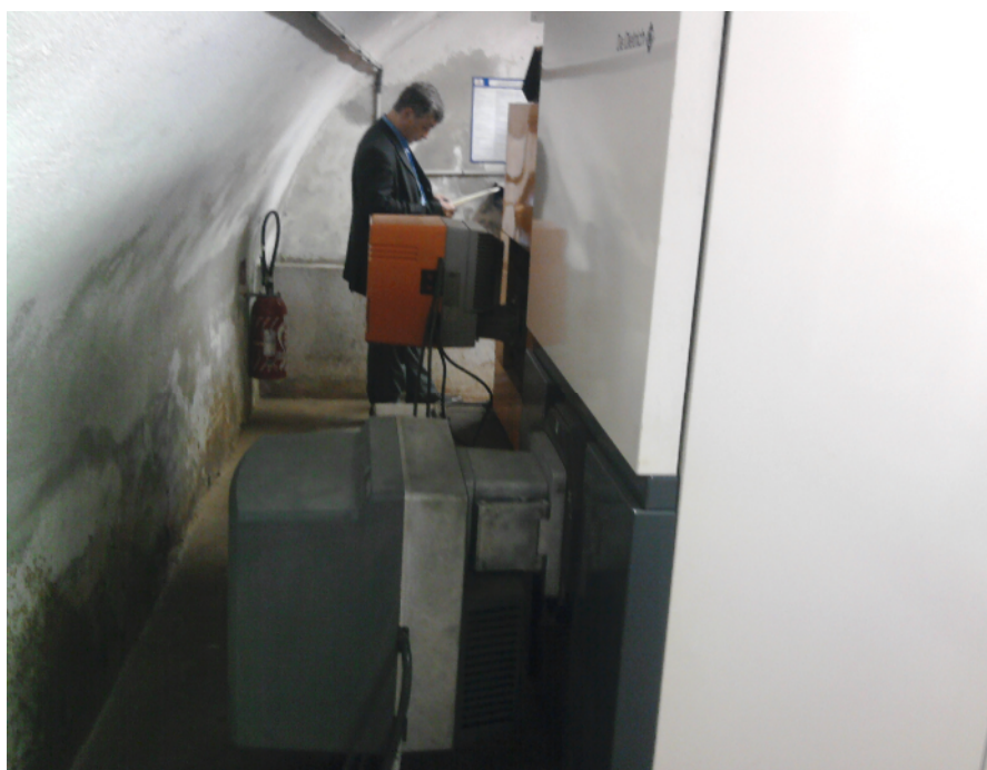
Figure 2 : Chaudière De Dietrich GT409
