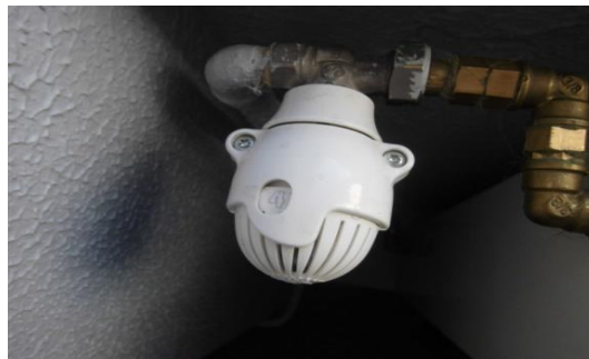
Thermostat bridé - bâtiment D
