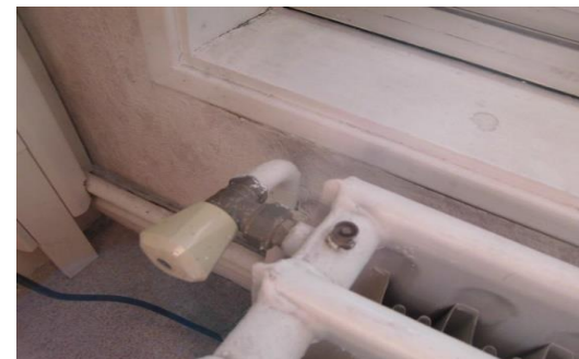
Détail robinet classique bâtiment E
