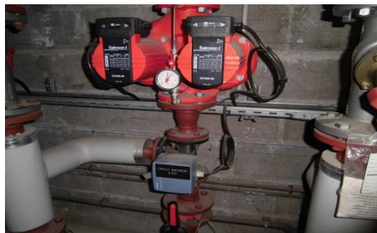
Circulateur bâtiment D Est
