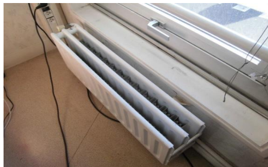
Radiateur bâtiment E
