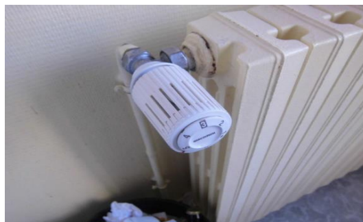
Robinet thermostatique : bâtiment B
