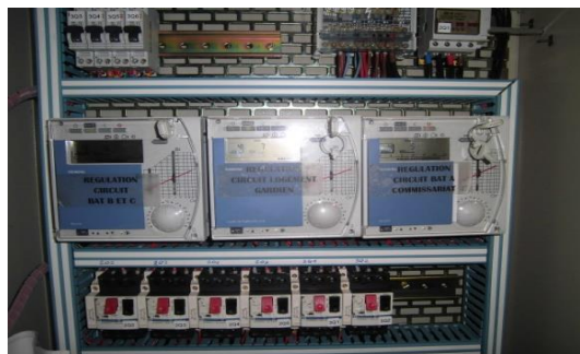
Régulateurs des différents réseaux
