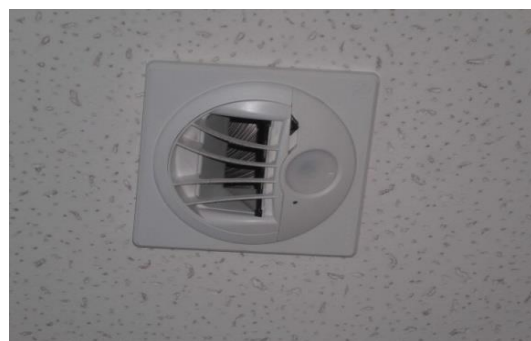
Bouche d'extraction asservie à la présence
