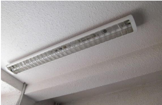
Éclairage fluorescent obsolète
