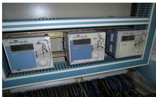
Régulateurs des réseaux de chauffage
