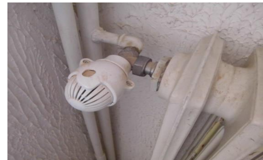
Thermostat bridé - bâtiment D
