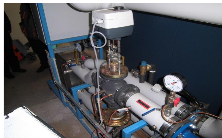
Vanne de régulation de l'échangeur
