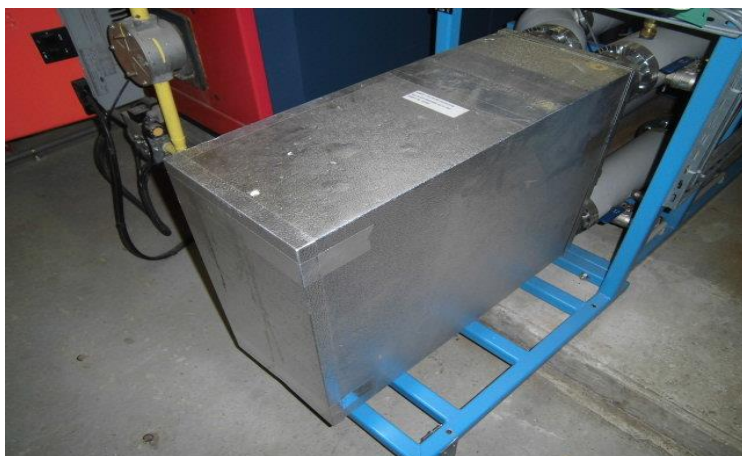
Échangeur réseau urbain
