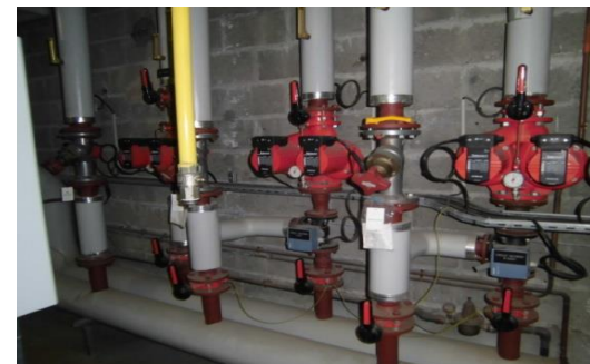
Départ en chaufferie
