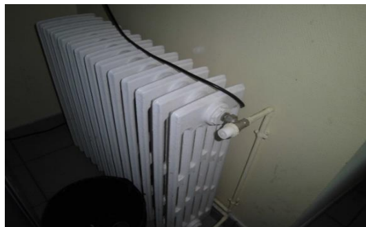
Radiateur non-thermostaté : commissariat
