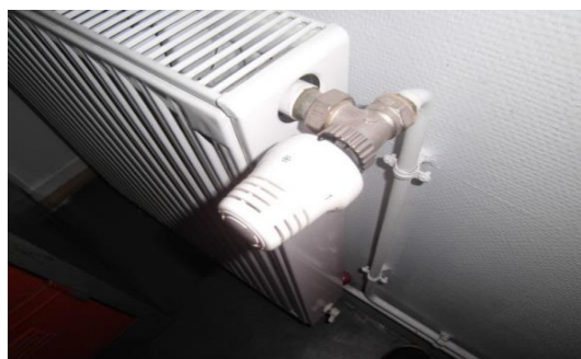
Robinet Thermostatique : Bâtiment A
