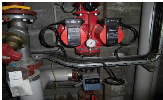
Circulateur bâtiment D ouest
