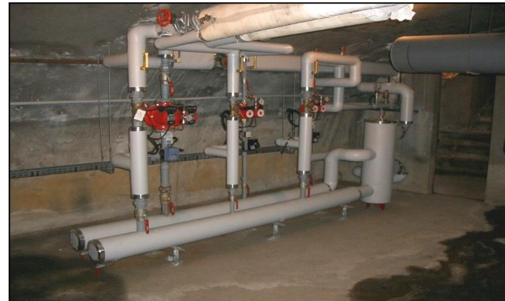
Départ des réseaux en sous-station
